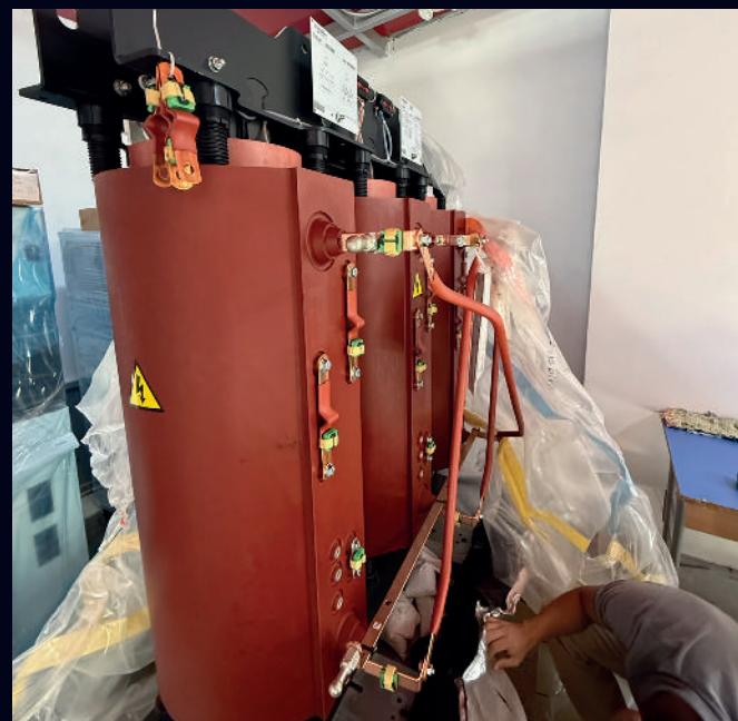
Transformadores Schneider importados desde Francia para importante cliente
